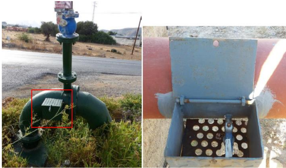
Figura 2- Detalles de los grifos instalados en los sondeos.
